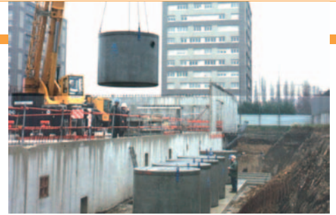
SÉPARATEURS D'HYDROCARBURES POUR UN DÉPÔT DE BUS
